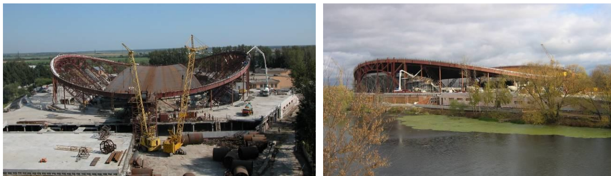
Рис. 1. а) Подача рулонированных полотнищ мембраны, их раскатка по временным элементам постели. б) Законченное мембранное покрытие, вид с противоположного берега реки Коломенка
